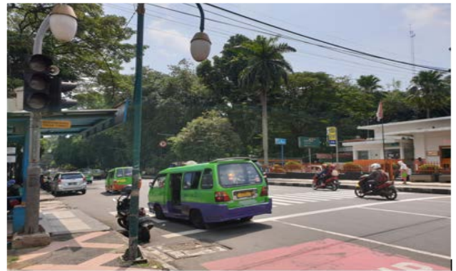
Gambar 1. Lampu bantu penyeberangan yang rusak
