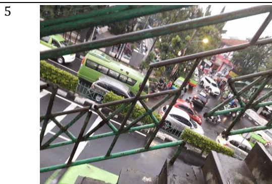
5 Kondisi Pegangan atau sandaran JPO yang sudah keropos.
