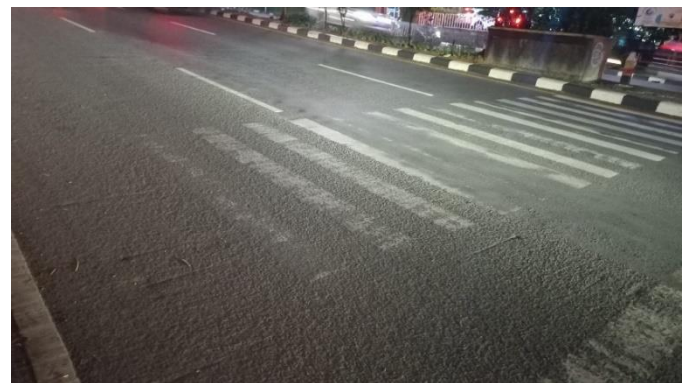
Gambar 5. Kondisi Marka Jalan
