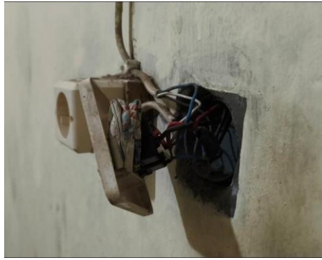
Gambar 2. Penggunaan Kabel yang tidak sesuai Standar
