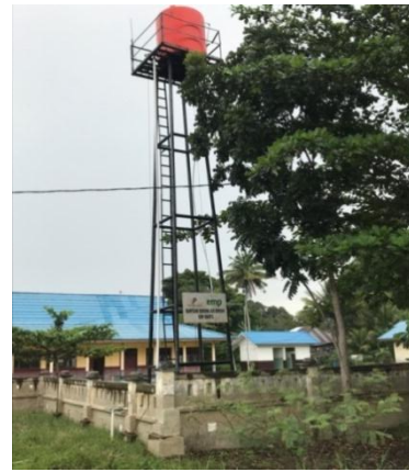
Gambar 3 Sumur Bersih yang Disediakan EMP Bentu Ltd
