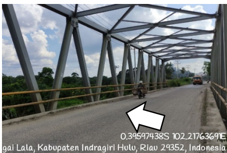
Gambar 5. Kondisi Lantai Permukaan Aspal
