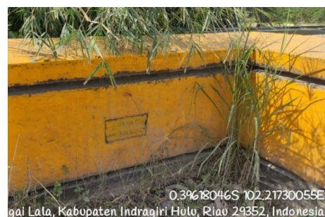
Gambar 9. Kondisi Tembok Sedada (Parapet)
