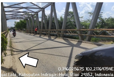
Gambar 6. Kondisi Lubang Drainase
