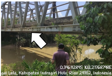
Gambar 4. Kondisi Baja yang Berkarat
