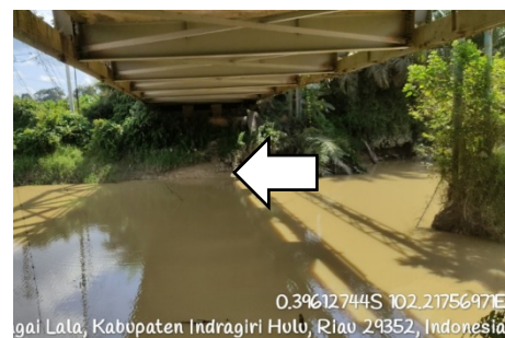
Gambar 2. Kondisi Kerusakan pada Penahan Tanah Pondasi
