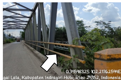
Gambar 8. Kondisi Sandaran Pejalan Kaki
