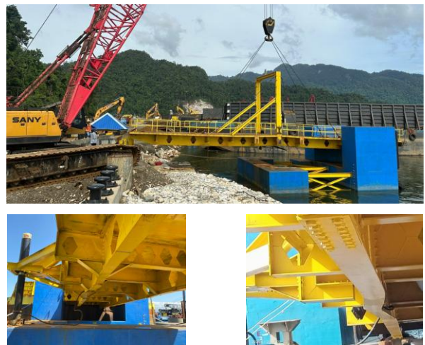
Gambar 3. Struktur Ramp door mengalami kerusakan ( buckling ) pada balok induk.
