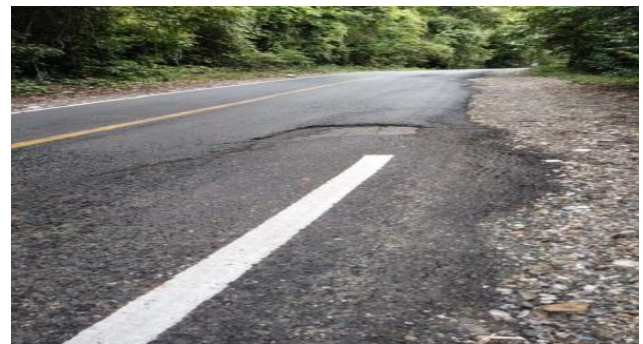
Gambar 6. Kondisi Ruas Jalan Hutan Tamborasi
